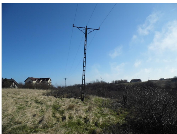
linia średniego napięcia w północno-zachodniej części
