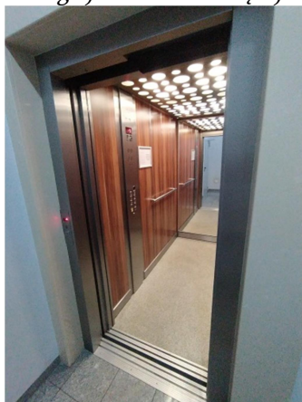
winda w budynku
