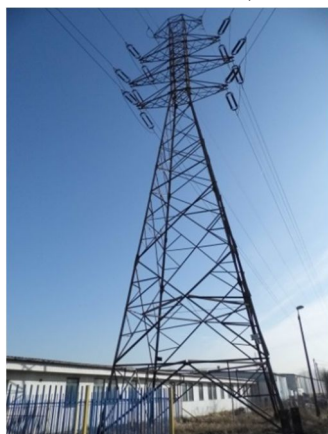
słup linii wysokiego napięcia przy granicy południowej
