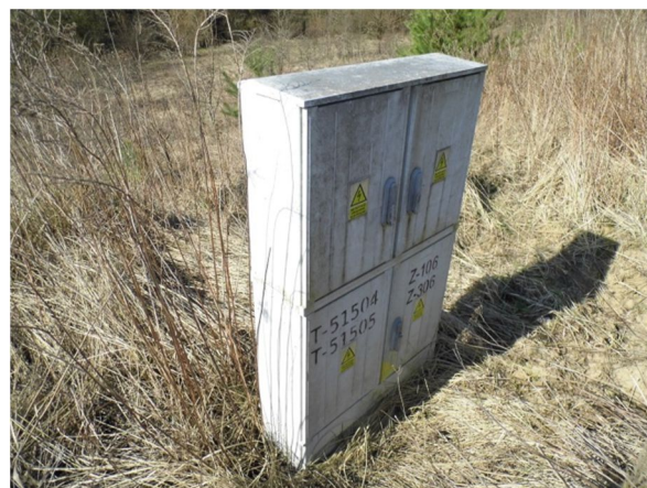
skrzynka elektryczna w płn.-wsch. narożniku działki
