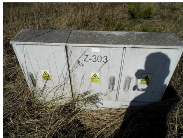
skrzynka elektryczna w płd.-zach. narożniku
