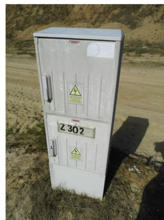
skrzynka elektryczna w płd.-zach. narożniku
