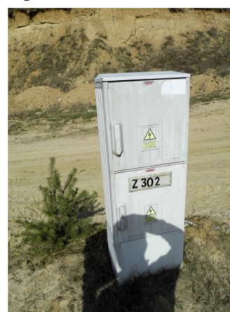
skrzynka elektryczna w płd.-wsch. narożniku
