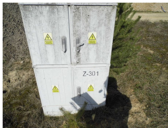
skrzynka elektryczna w płd.-zach. narożniku
