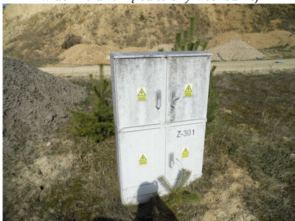
skrzynka elektryczna w płd.-wsch. narożniku
