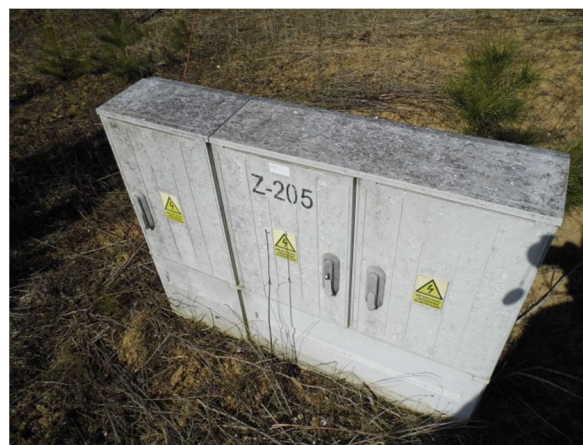
skrzynka elektryczna w połd.-wsch. narożniku
