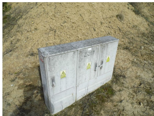
skrzynka elektryczna w płd.-wsch. narożniku
