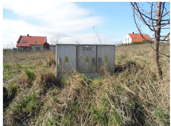
skrzynka elektryczna w płn.-wsch. narożniku
