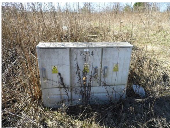
skrzynka elektryczna w płd.-wsch. narożniku
