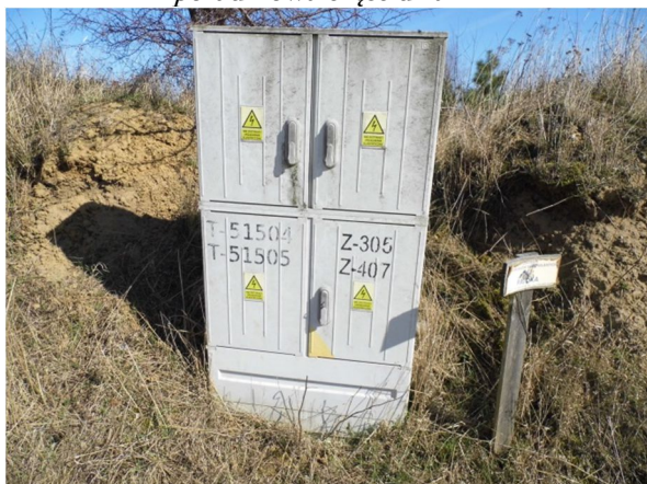
skrzynka elektryczna w płd.-zach. narożniku
