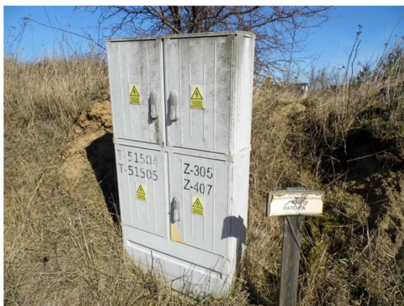
skrzynka elektryczna w pñ.-zach. narożniku
