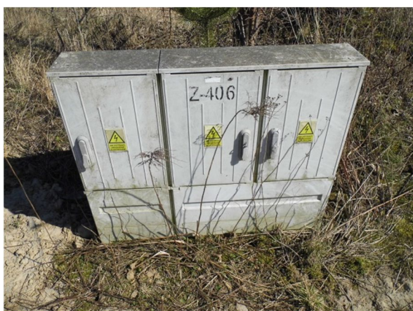
skrzynka elektryczna w płd.-zach. narożniku
