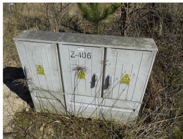
skrzynka elektryczna w płn.-zach. narożniku
